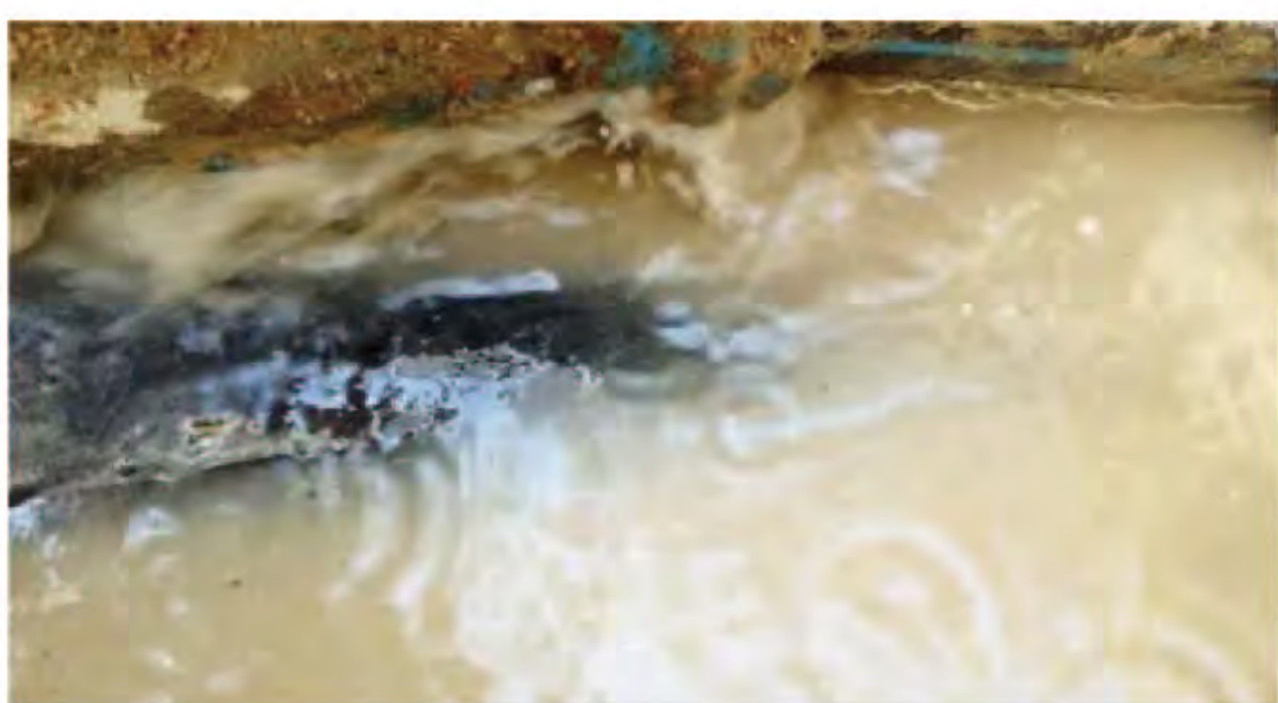
倒虹管破裂、淤堵
