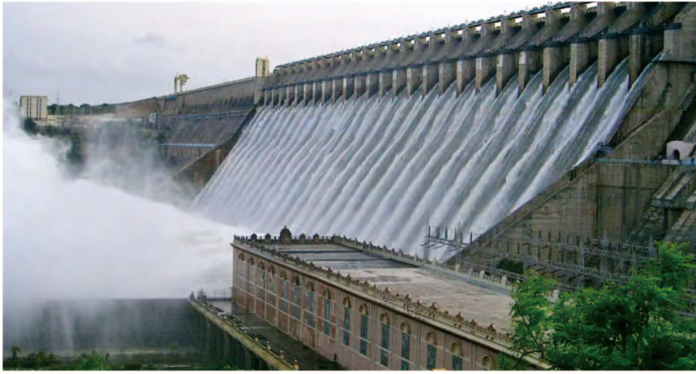
大坝结构安全监测
